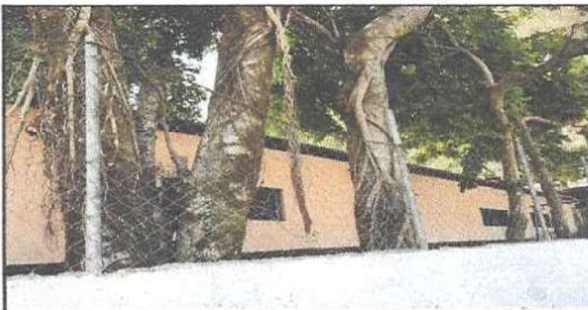
FOTO 5: MALLA PERIMETRAL EN MAL ESTADO.
