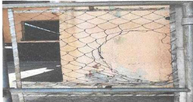
FOTO 6: MALLA DE PUERTA PRINCIPAL EN MAL ESTADO.
