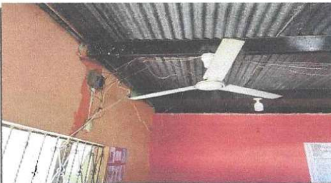
FOTO 3. INSTALACIÓN ELÉCTRICA EN MAL ESTADO.
